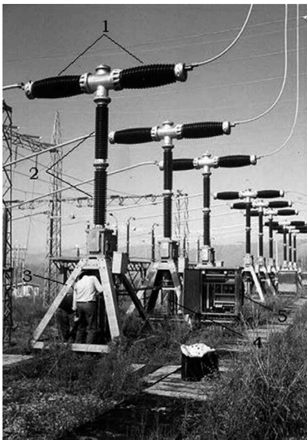
Figura 1. Interruptores de potencia tipo FL245
