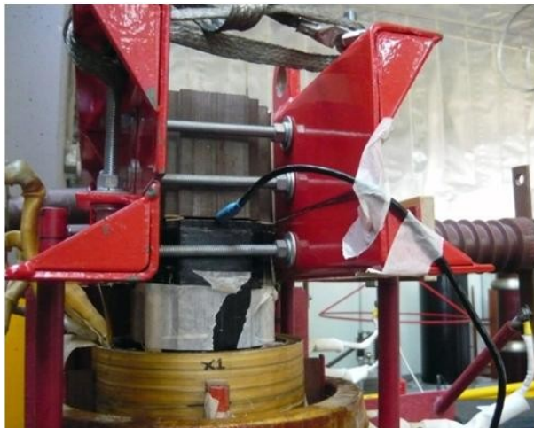
Fig.12. Disposición física del gaussímetro en el transformador.
