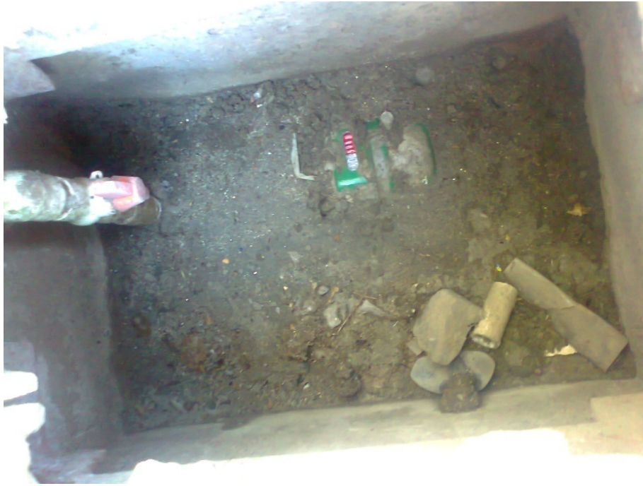
Ilustración 10.1 Medidor Tipo Volumétrico Ø ½" obstruido
