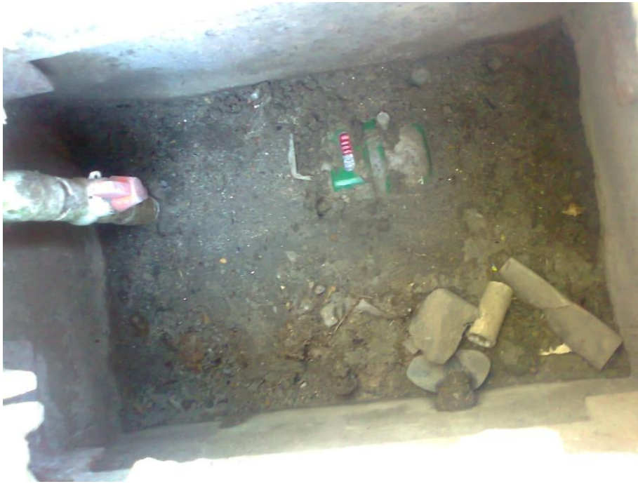
Ilustración 10.1 Medidor Tipo Volumétrico Ø ½" obstruido
