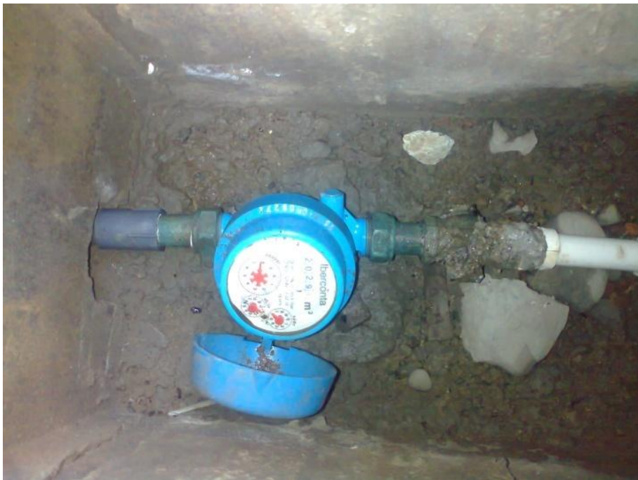
Ilustración 10.2 Medidor Tipo Velocidad Ø ½" en posición incorrecta
