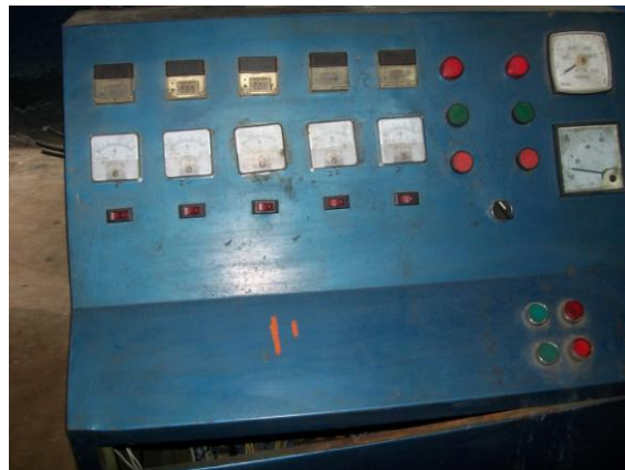
FOTO 6. TABLERO DE CONTROL
