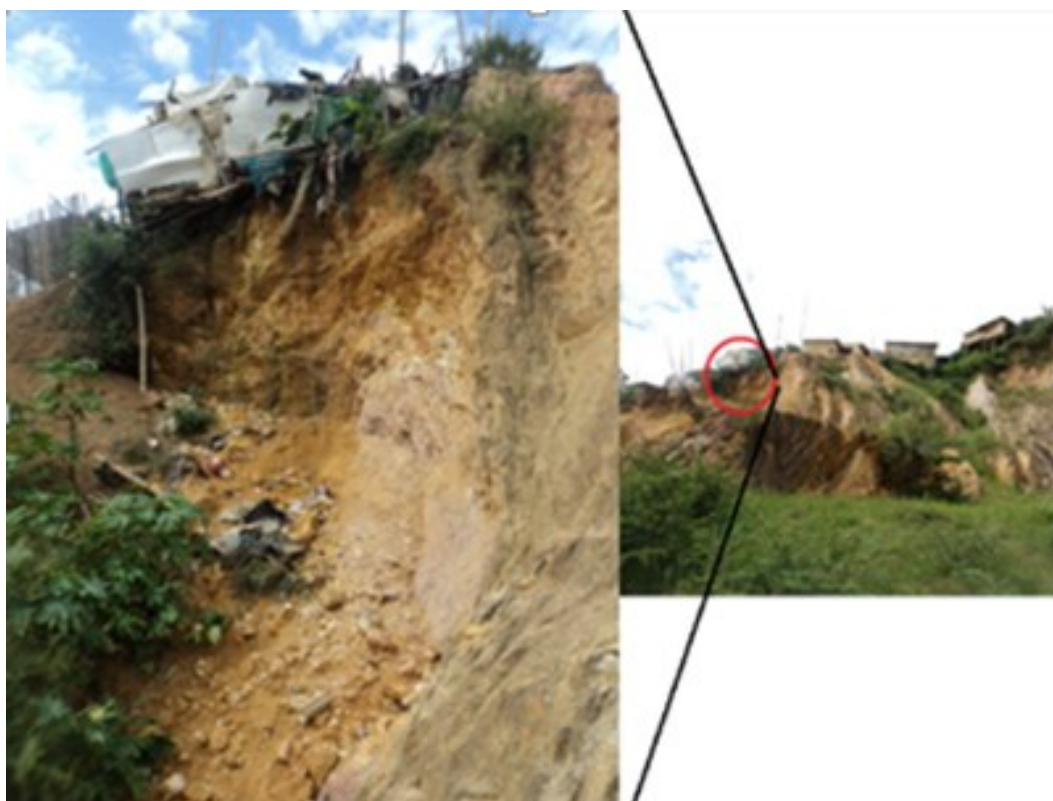
Foto 5. Vivienda que presenta riesgo de derrumbarse
