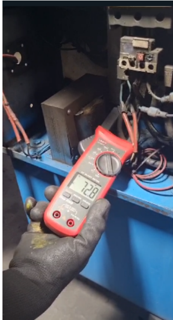
Figura 5.10: Medición de corriente y voltaje en la entrada del motor del compresor
