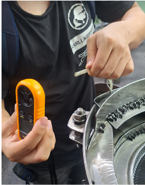
Figura 5.7: Medición del caudal de operación
