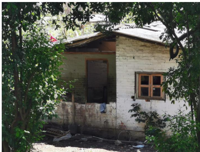
Ilustración 18. Vivienda con sistemas constructivos críticos y mal estado de conservación Fuente: Registro Fotográfico propio.
