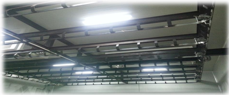
Imagen 9 Motor de izado y rielaria de cuarto N°4 de la empresa Frigorivalle S.A.S
