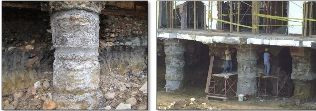
Imagen 9. Anillos de concreto descubiertos en sótano.
