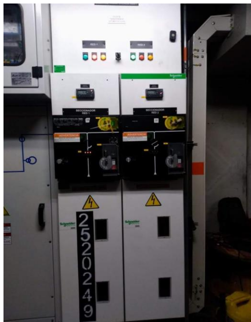
Figura 19. Transferencia de media tensión
