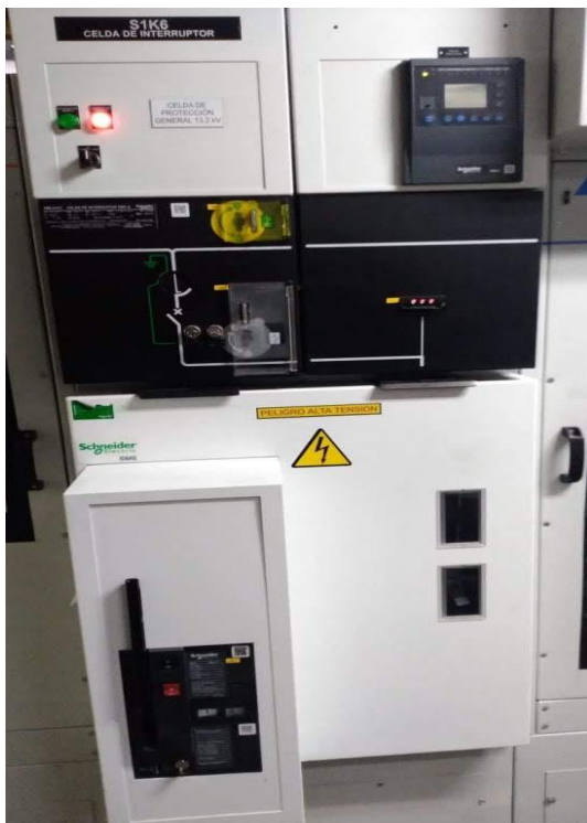
Figura 20. Celda de protección con interruptor automático
