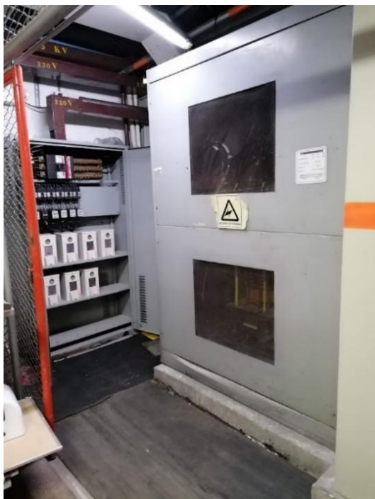
Figura 27. Subestación sótano 1 – Torre A
