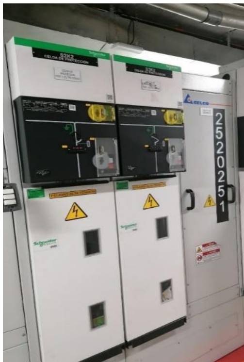
Figura 21. Tren de celdas Torre A y Torre B
