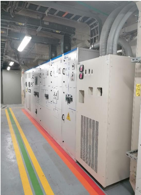
Figura 31. Subestación Torre C
