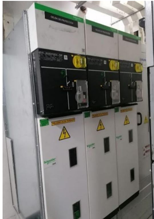
Figura 23. Tren de celdas en SF6 Torre A
