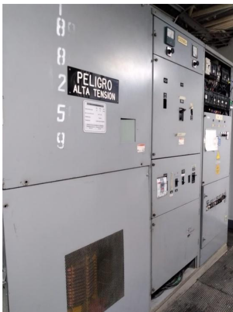
Figura 25. Subestación piso 1 – Torre A
