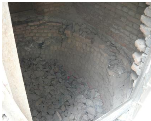
Figura 4. Alimentación en horno vertical industrial.
