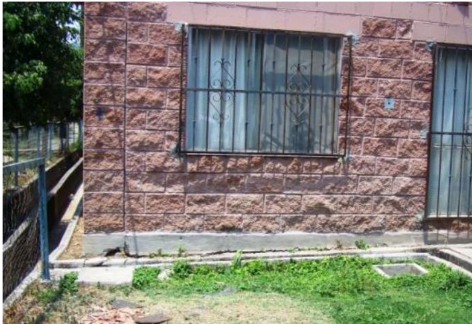
Ilustración 3. Daño producido por efecto de expansión de las arcillas, se nota levantamiento de losa. Morelos, México.
