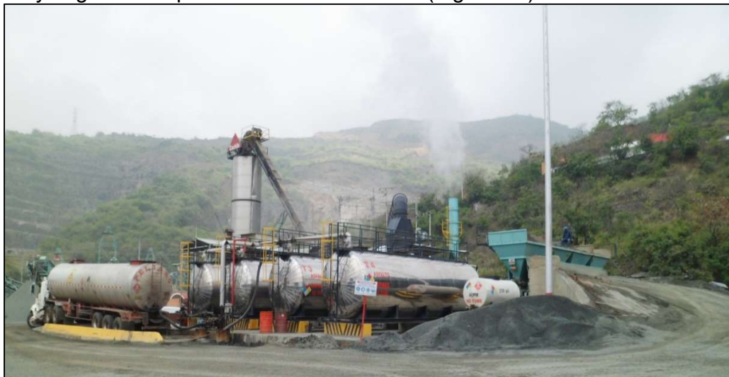
Figura 21. Planta de Asfalto
