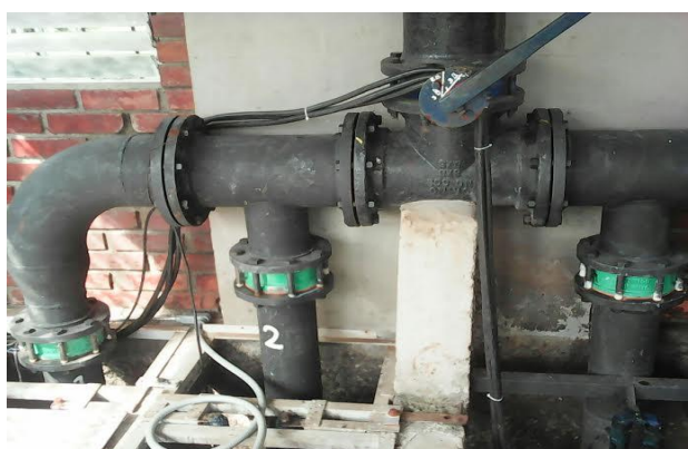
Figura 17. Estación de bombeo.
