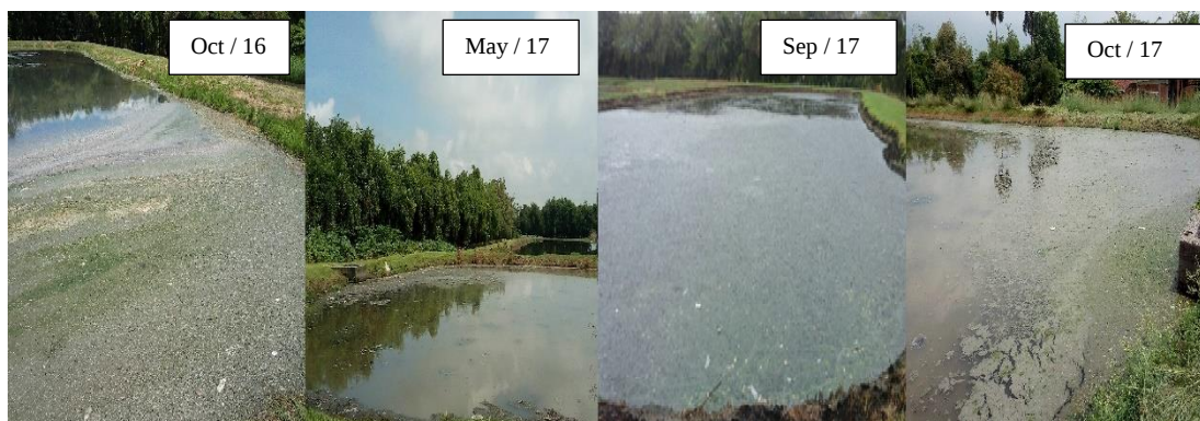
Figura 18. Taludes están sin revestir - Laguna anaerobia
