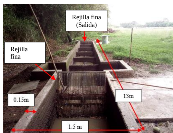
Figura 10. Tratamiento preliminar – Rejillas y desarenador.
