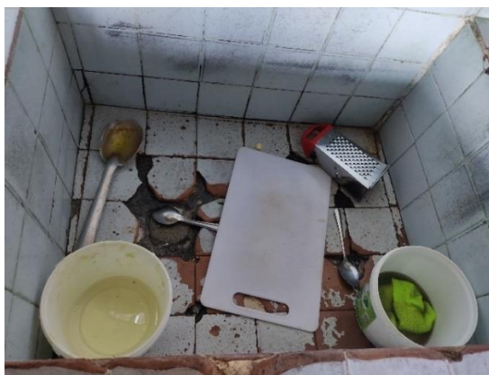
Figura 36: Condiciones en las que se encuentra el lavaplatos.
