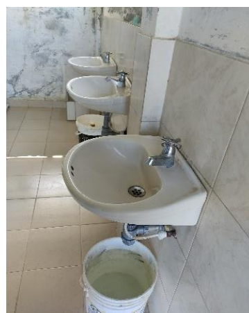
Figura 29: Lavamanos y baldes para agua.
