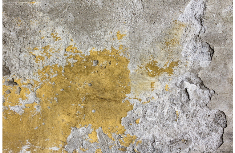
Figura 09, Pared con pintura deteriorada
