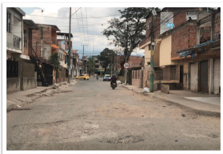
Imagen 3. Mal estado de la vía pública en general
