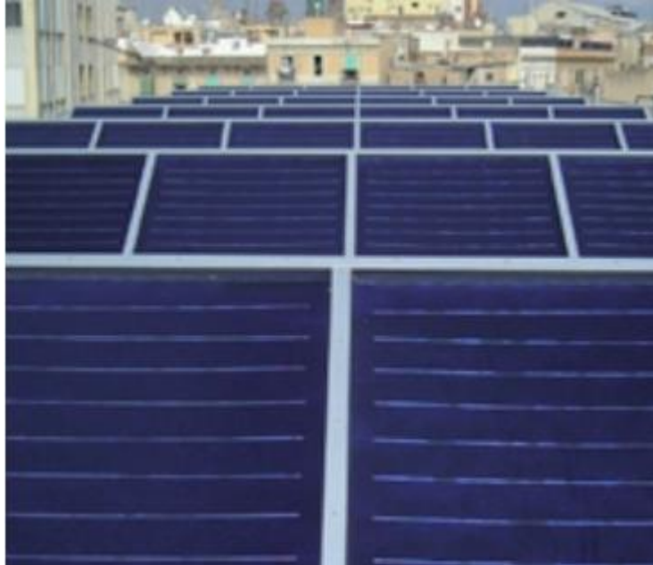
Figura 8. Captadores planos selectivos con cubierta anti reflectante en instalación de climatización solar. Edificio Peracamps. Barcelona.
