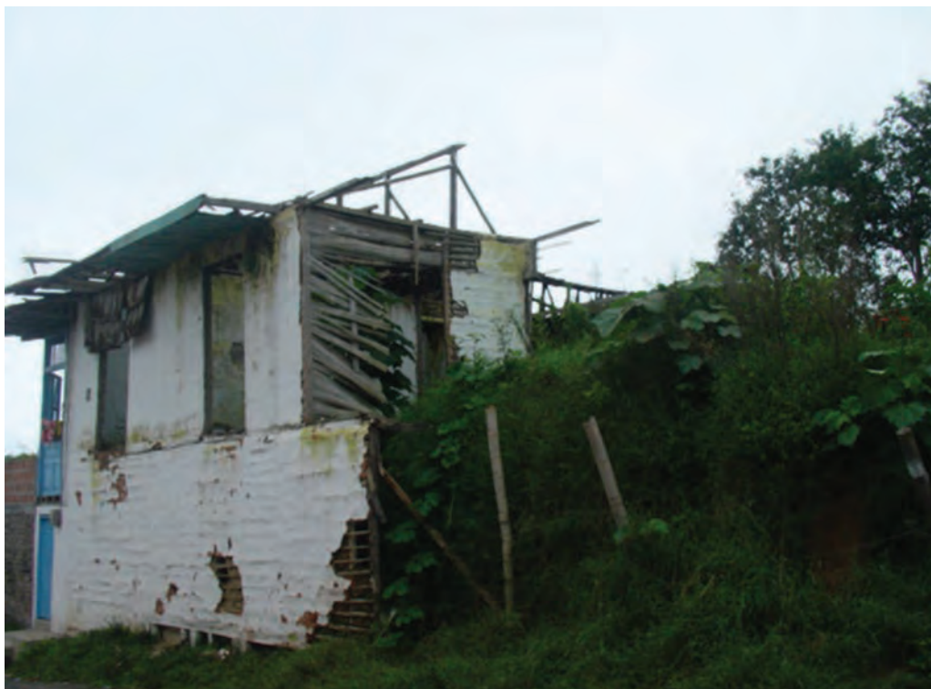
Vivienda en deterioro. Municipio El Cairo. Foto: CITCE
