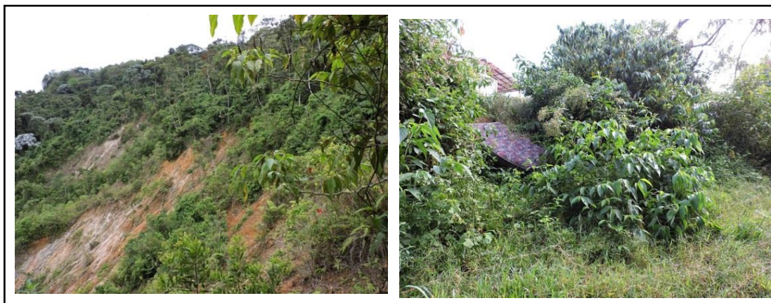
Figura 43. Fotografías cárcava en la Reserva Forestal La Reina y de disposición inadecuada de residuos sólidos.
