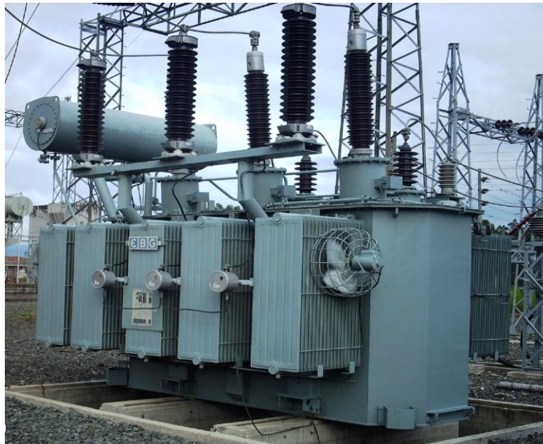
Figura 2. Transformador de potencia trifásico.
