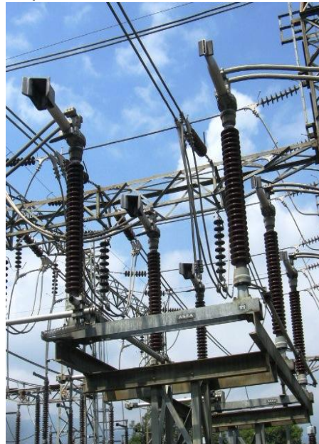
Figura 6. Seccionador de apertura central.
