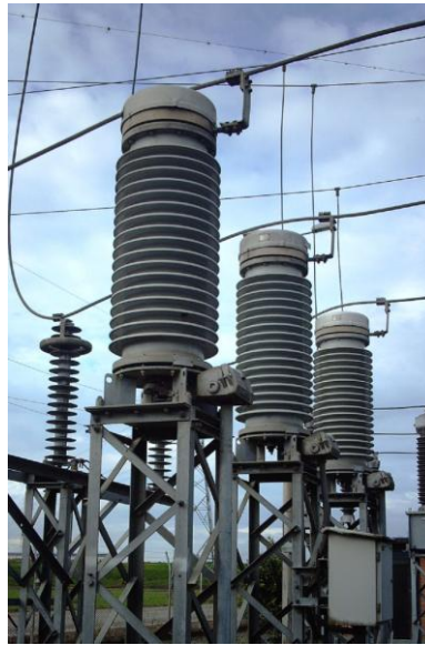
Figura 3. Transformadores de potencial.
