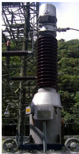
Figura 4. Transformador de corriente.
