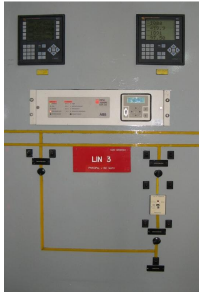
Figura 70. Tablero de mando típico.
