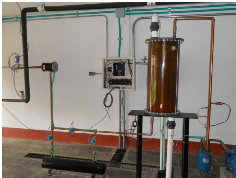
Figura 3. Cableado inadecuado de los sensores y válvulas solenoides.
