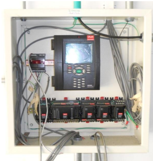
Foto 2. Estado inicial del gabinete de control.
