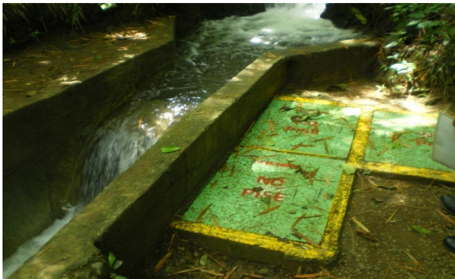
Figura 30. Obra de toma perteneciente a ECOPETROL
