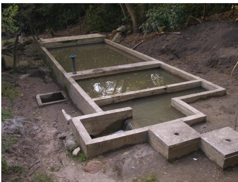
Figura 5. Desarenador de agua en Corinto.
