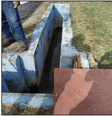
Figura 16. Punto de salida del efluente
