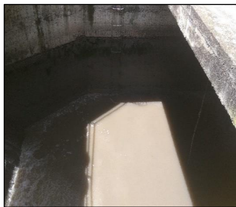
Figura 13. Ingreso del efluente
