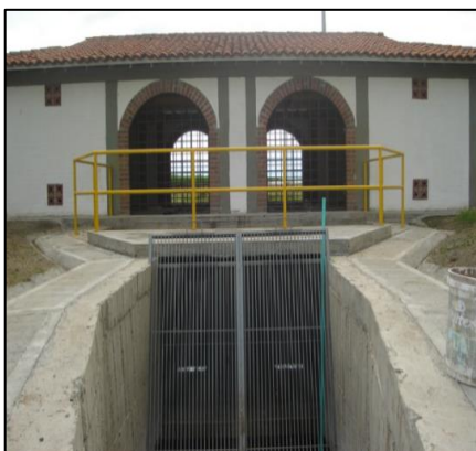
Figura 12. Rejillas y desarenador
