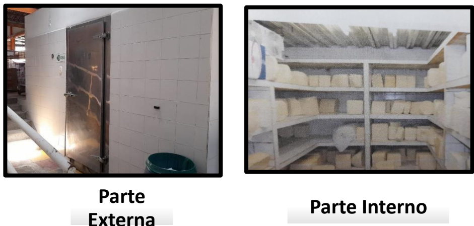
Ilustración 35. Cuarto frio – Cava.
