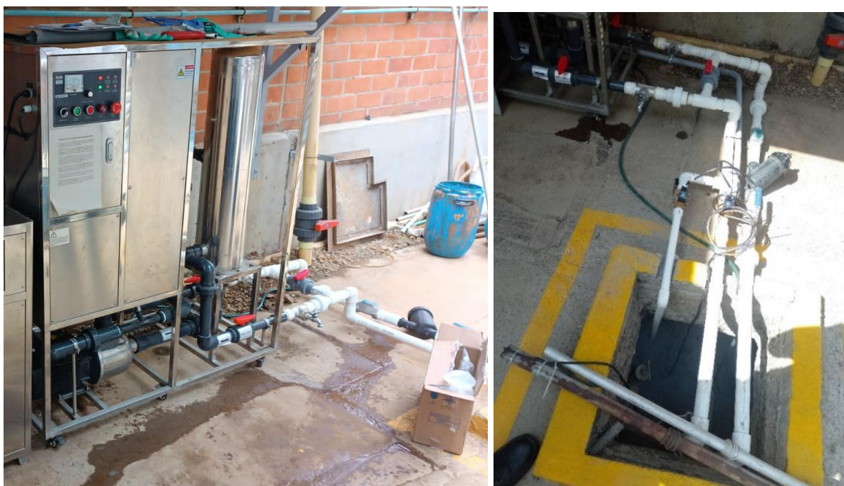
Figura 8. Equipo en las instalaciones de la empresa y pozo de agua residual.
