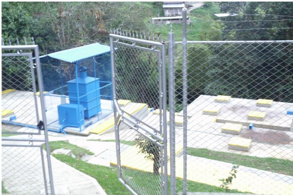
Fotografía 4. Vista del sistema de tratamiento
