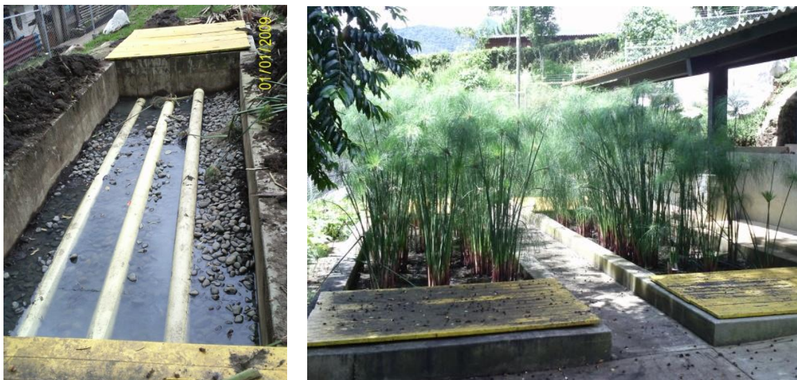
Fotografía 10. Humedales contruidos horizontales de flujo subsuperficial
