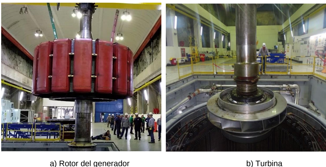
Figura 1.1. Rotor del generador y turbina Francis de la CHAA
