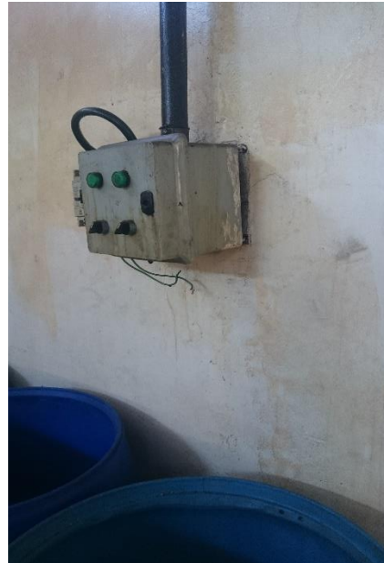
Ilustración 1 cables sueltos en cajas eléctricas.
