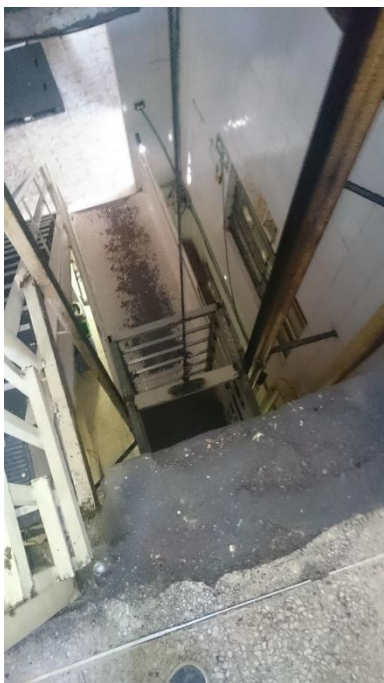
Ilustración 6 Riesgo de caída al vacío
