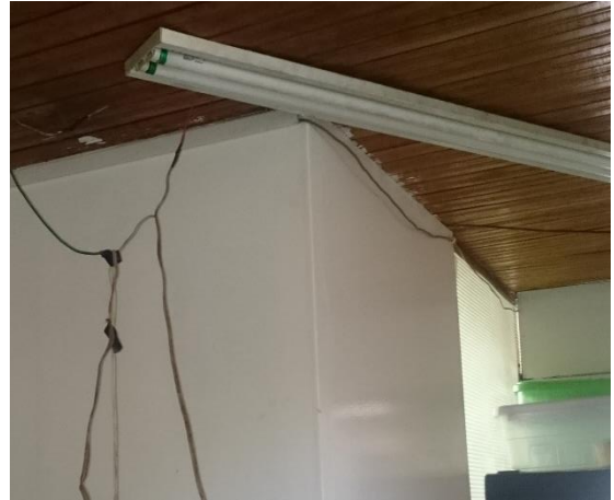
Ilustración 2 cables colgantes en instalaciones de lámparas
