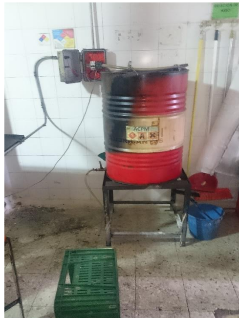
Ilustración 7 tanque de combustibles sin guardas y cerca a chispa eléctrica
