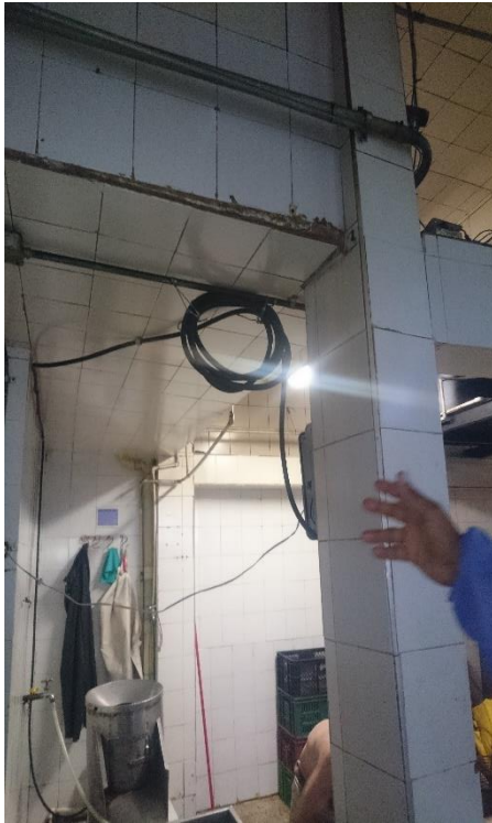
Ilustración 3 cables enrollados en las instalaciones eléctricas de mediana tensión.
