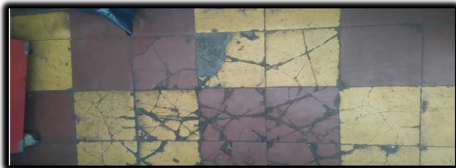
Figura 3. Estado actual de los pisos
