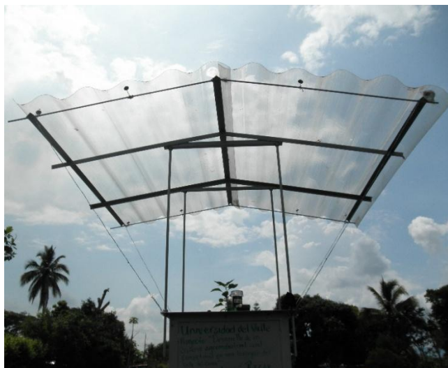
Figura 23. Techo y su estructura de los lisímetros instalados en el predio.
