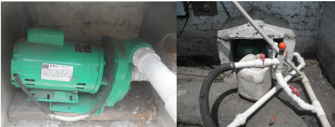
Figura 12. Bomba eléctrica de 2 Hp y sistema de bombeo instalado en el predio.
