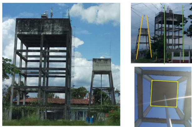
Figura 27 Tanques de abastecimiento ASDAL
