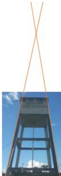
Figura 29 Tanque de abastecimiento de agua (Pequeño)
