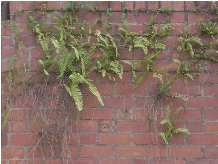
Fuente: autor. Helecho que ha crecido de manera espontanea en fisuras de la pared de ladrillos, es decir no fueron plantados alli intensionalmente por algun ser humano sino que su crecimiento se debe a factores no antropicos.
