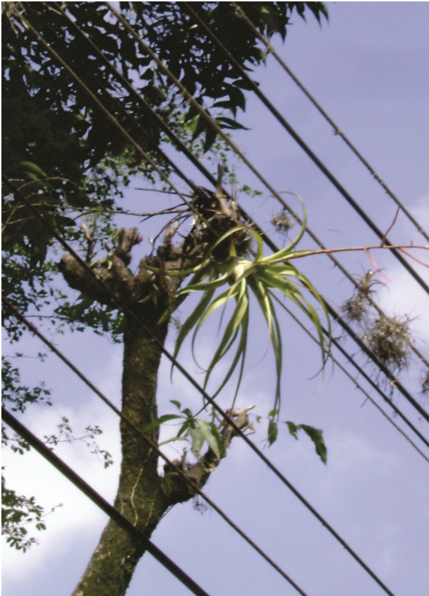
Fuente: autor Tillandsia elongata creciendo sobre un cable eléctrico.
