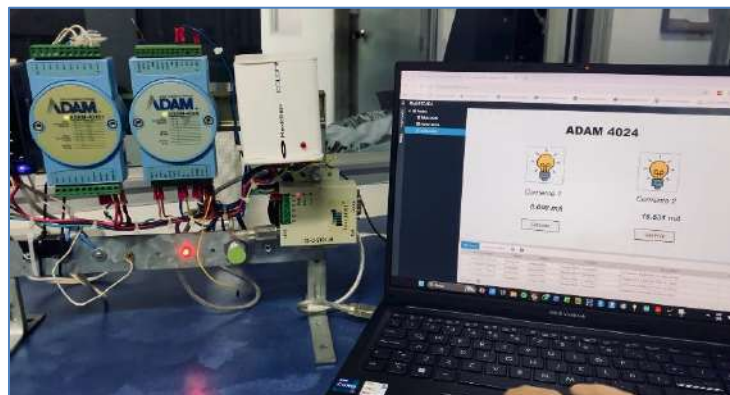
Figura 5.4.4 Montaje físico del sistema ADAM (4018+ y 4024) y verificación de escritura de consignas desde Webstation mediante Modbus RTU.
