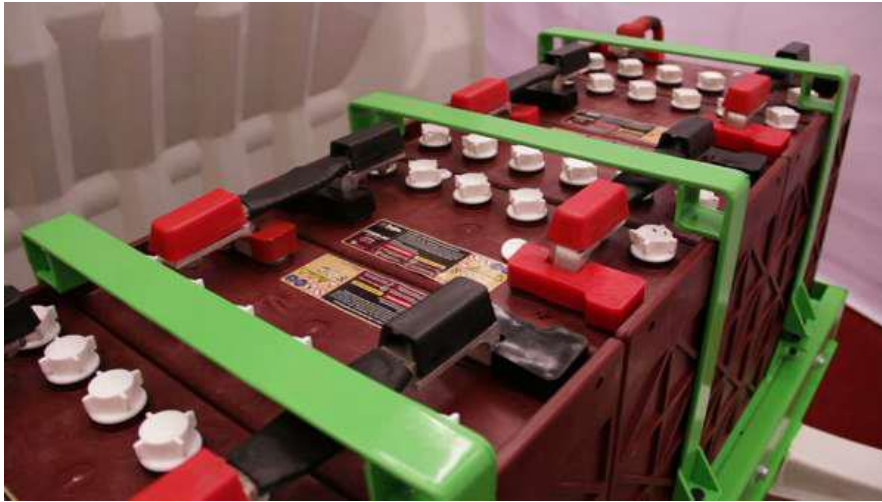
Figura 28. Ejemplo de soporte para baterías
