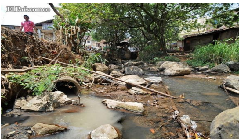
Figura 14: Conexión irregular del alcantarillado sector la Sirena
