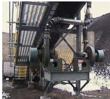
Figura 6. Ventilador redundante en un transportador aero soportado Fuente: Foundations 6ª Ed. Autor: Martin Engineering
