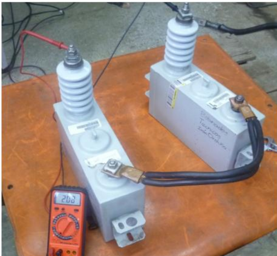
Figura 59. Conexión en serie del banco de condensadores 7.6kV
