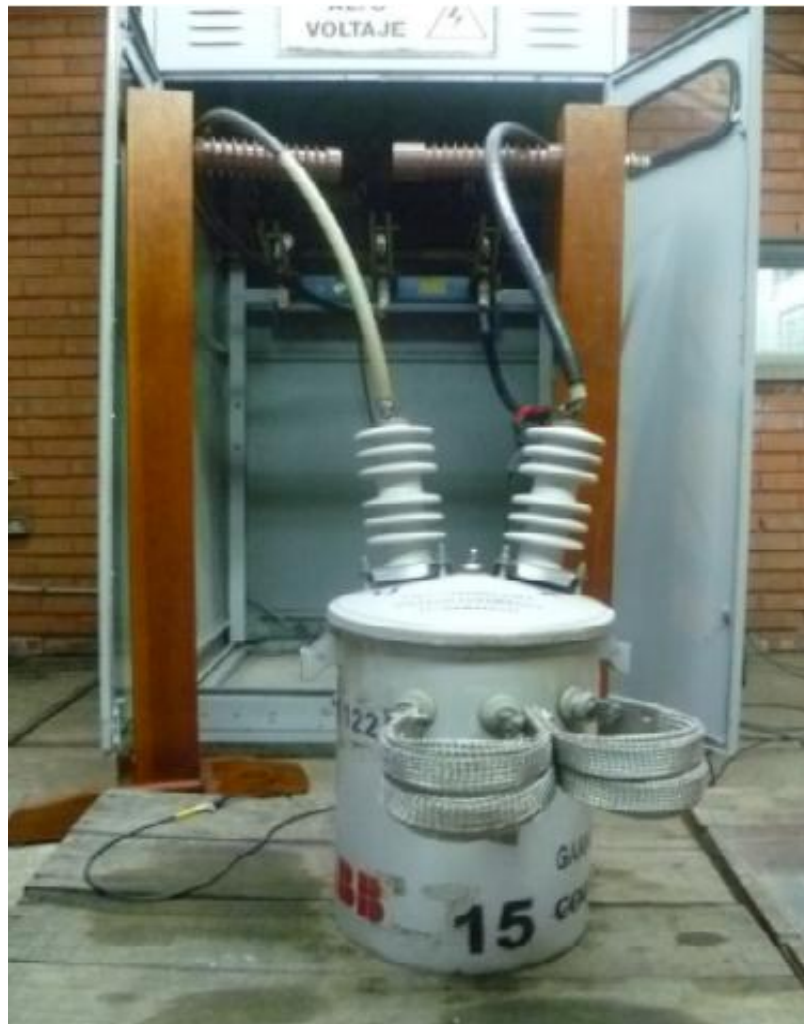
Figura 58. Prueba de cortocircuito a tensión nominal al transformador 15kVA
