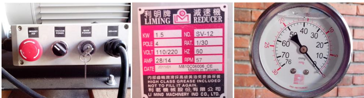
Figura 13. Panel de control, tabla de características del motor y manómetro de la bomba de vacío. (Castaño et al. 2014).
