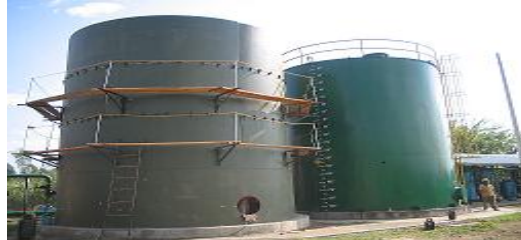
2. Tanque de almacenamiento
