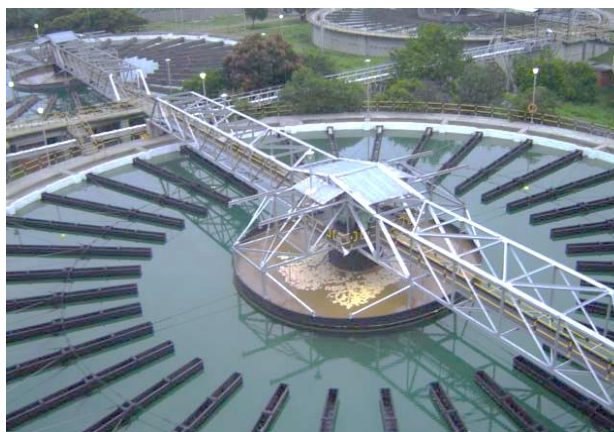
Figura 5.21 Reactores. Tomada de: manual de operaciones Puerto Mallarino, 2011.
