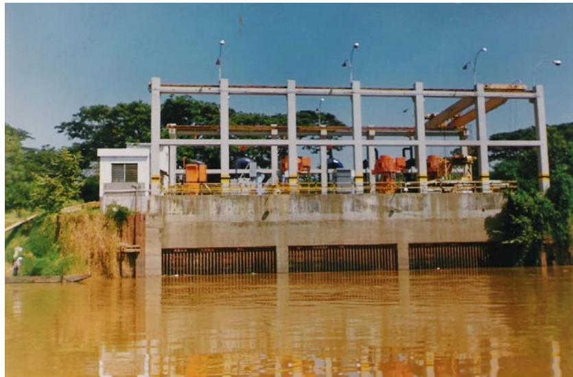
Figura 5.19 Entrada bocatoma. Tomada de: manual de operaciones Puerto Mallarino, 2011.
