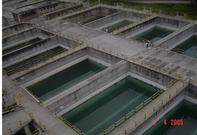
Figura 5.22 Filtros rápidos para agua clarificada. Tomada de: manual de operaciones Puerto Mallarino, 2011.
