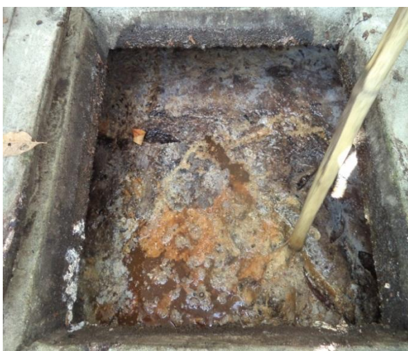
Figura 34. Foto Manejo de lixiviados Fuente: Los Autores
