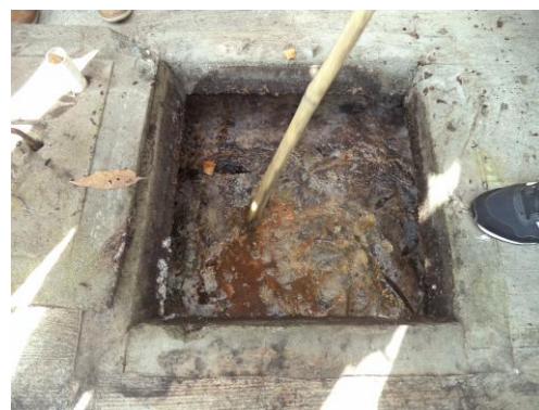
Figura 36. Foto Fosa lixiviados Fuente Los Autores
