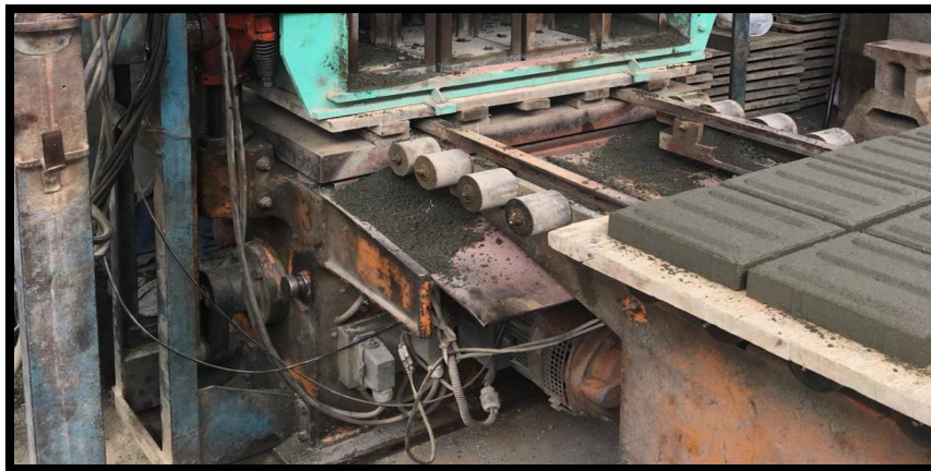
Ilustración 9. Bandas transportadoras de la bloquera Fuente. Elaboración propia.
