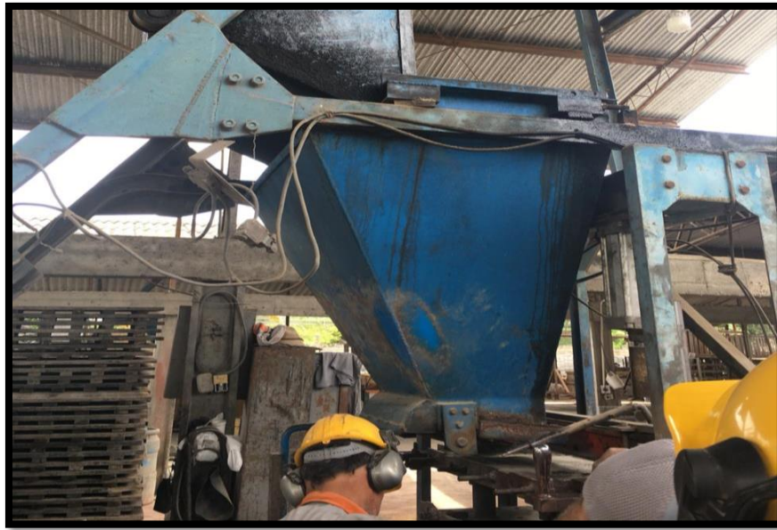
Ilustración 5. Tolva de la Bloquera Fuente. Elaboración propia.
