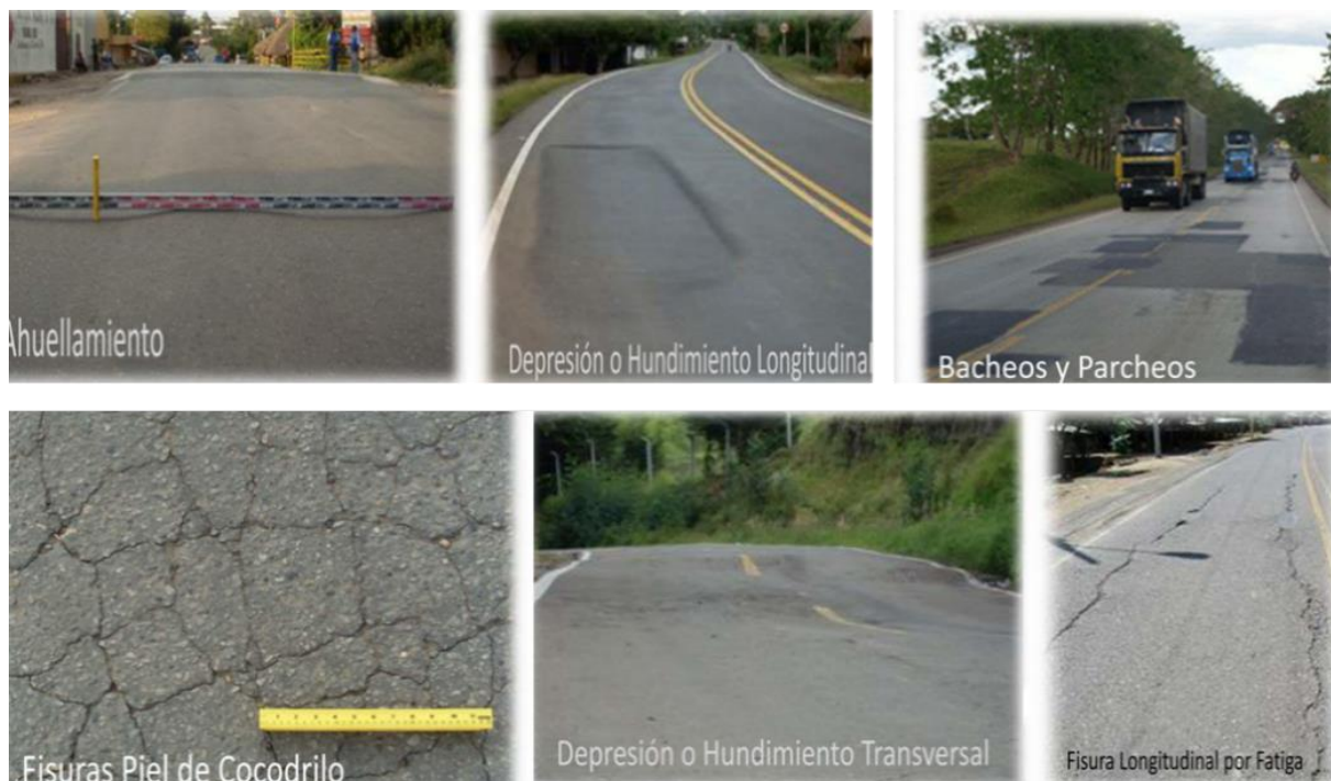
Figura 2 Deterioros del tipo A.
