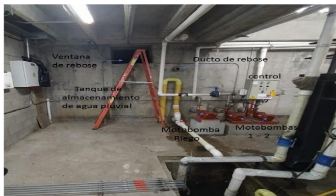
Ilustración 5 Sistema de almacenamiento y bombeo de agua.
