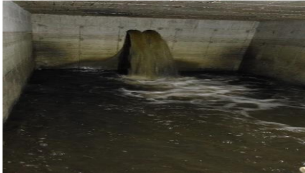
Ilustración 4 Tanque de almacenamiento de agua.
