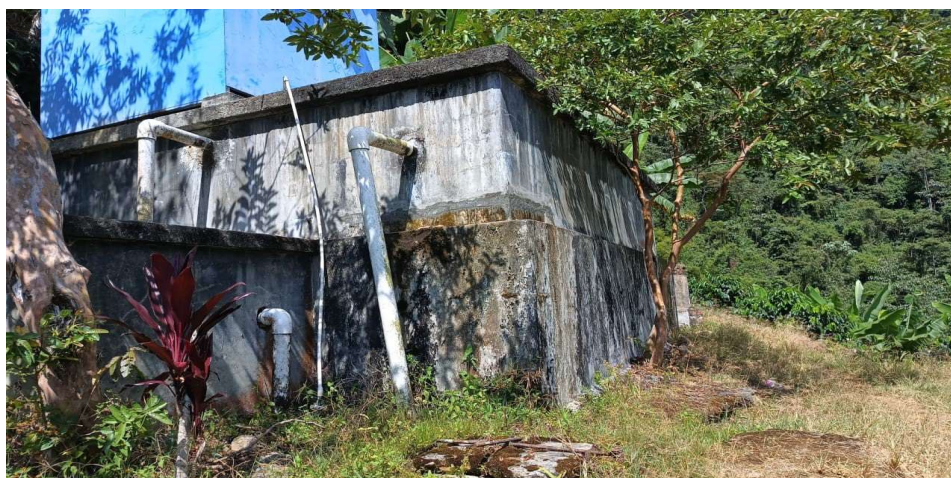
Figura 1: Acueducto vereda Morroplancho Fuente propia.
