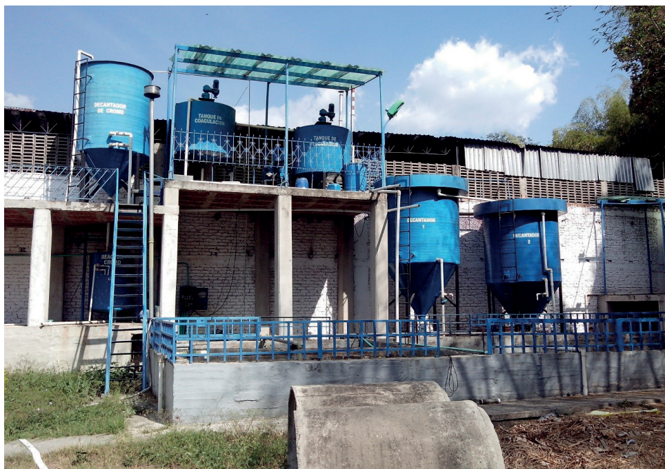
Fotografía 5. Planta de tratamiento de aguas residuales de Curtiembres La Cebra
