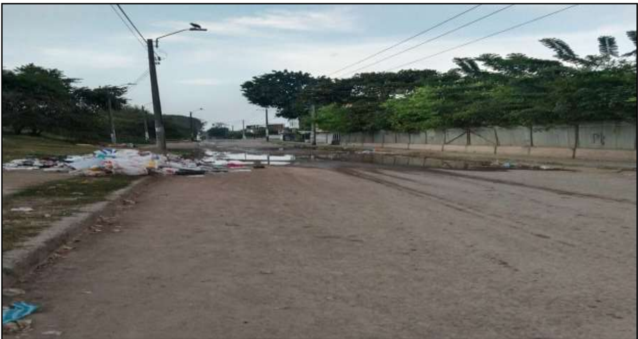
Figura 8. Mal estado de la vía en la Calle 126 con Carreras 26M3 y 26M4 del barrio Calimio Desepaz
