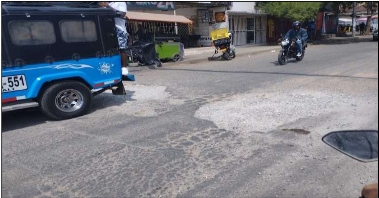
Figura 7. Mal estado de la vía en la Calle 123 con Carrera 26T del barrio Calimio Desepaz
