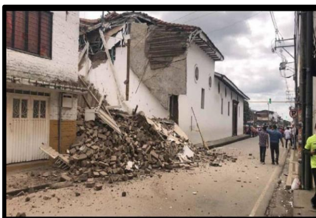
imagen 41 Colapso de infraestructura de la parroquia
